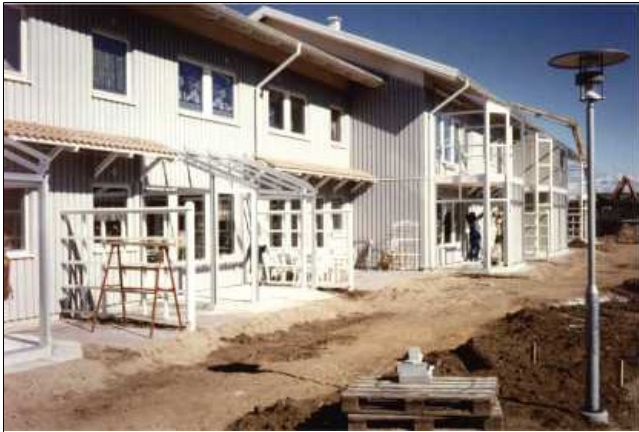
Ingolstadt-Halmstadt: Maisons basse énergie (30 kWh/(m 2 a) besoin de chaleur) de l'architecte Hans Eek (1985).
